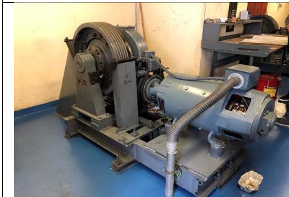
El Monte Courthouse - LA - Elevator
