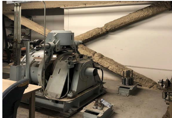
Van Nuys West Courthouse - LA - Elevator
