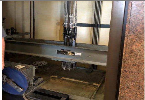
El Monte Courthouse - LA - Elevator
