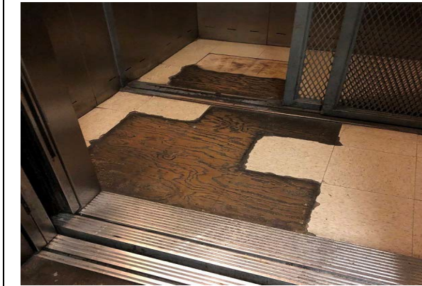
Van Nuys West Courthouse - LA - Elevator
