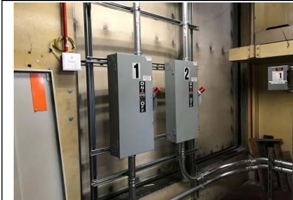
Van Nuys Courthouse/East - LA - Elevator
