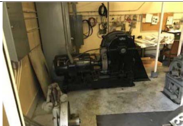
El Monte Courthouse - LA - Elevator
