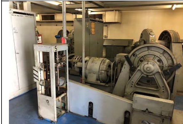
El Monte Courthouse - LA - Elevator
