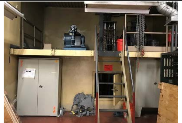
Van Nuys Courthouse/East - LA - Elevator
