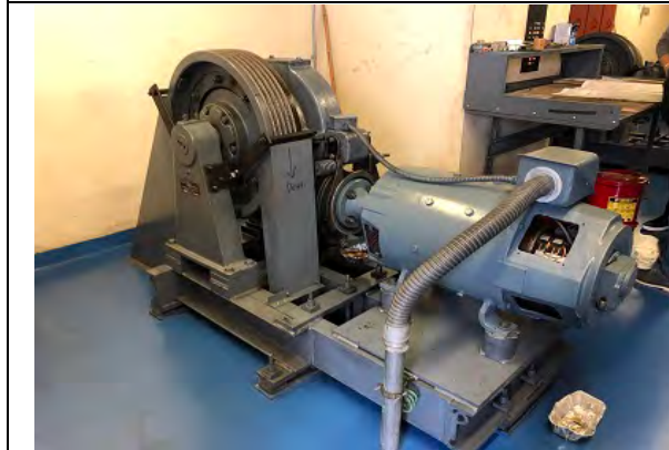
El Monte Courthouse - LA - Elevator
