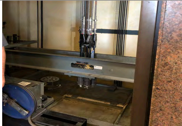
El Monte Courthouse - LA - Elevator
