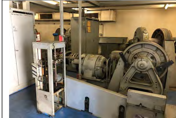
El Monte Courthouse - LA - Elevator
