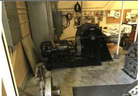
El Monte Courthouse - LA - Elevator
