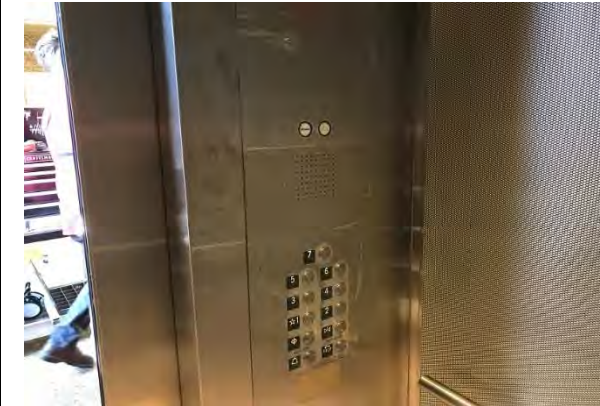
Van Nuys Courthouse/East - LA - Elevator
