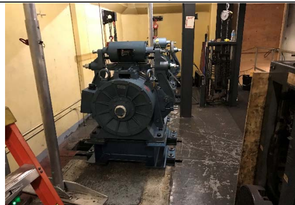
Van Nuys Courthouse/East - LA - Elevator
