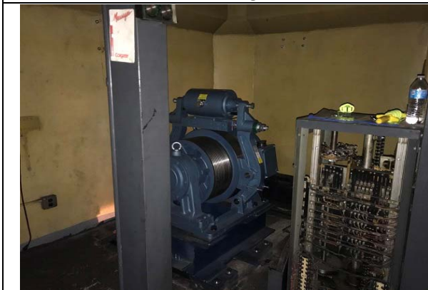
Van Nuys Courthouse/East - LA - Elevator
